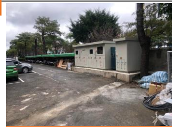
高壓變電站 ※地處偏僻 ※危險設施請勿觸碰
